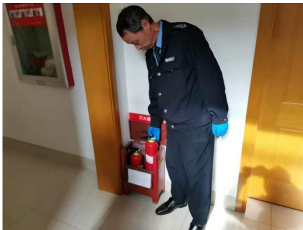
灭火器巡检（每月巡查有记录）
